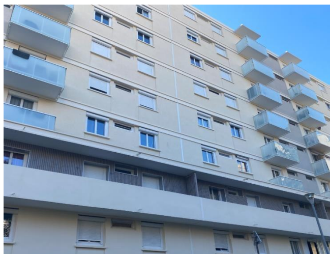
Rénovation de la copropriété les Faienciers (Marseille 11e - 61 copropriétaires) : ravalement complet des façades, remplacement des gardes-corps, des séparatifs de balcons et cache vide-ordure, rénovation extérieure des 15 halls d'entrée.
